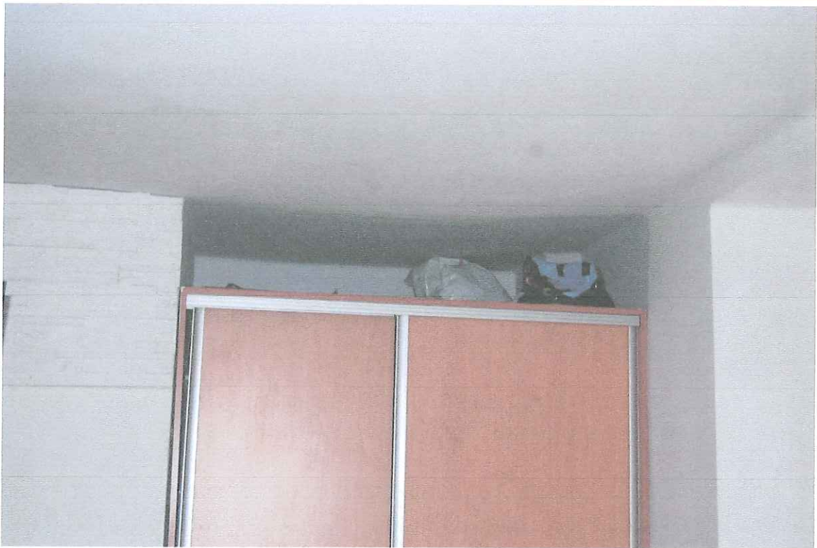
Fot. 7. Deformacja podsufitki stropowej.
